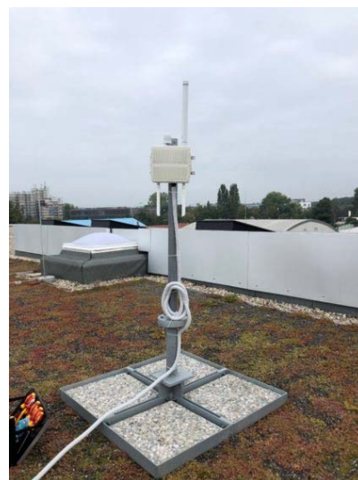
Das Gateway samt Mast wurde auf dem Dach der Klinik montiert, die Patientenzimmer und Diensträume wurden mit Sensoren ausgestattet, die unter anderem für ein besseres Raumklima sorgen. Das Gateway sammelt die Informationen der Sensoren und schickt diese zur Überprüfung an den Dienstleister energcity. © Sophienklinik
